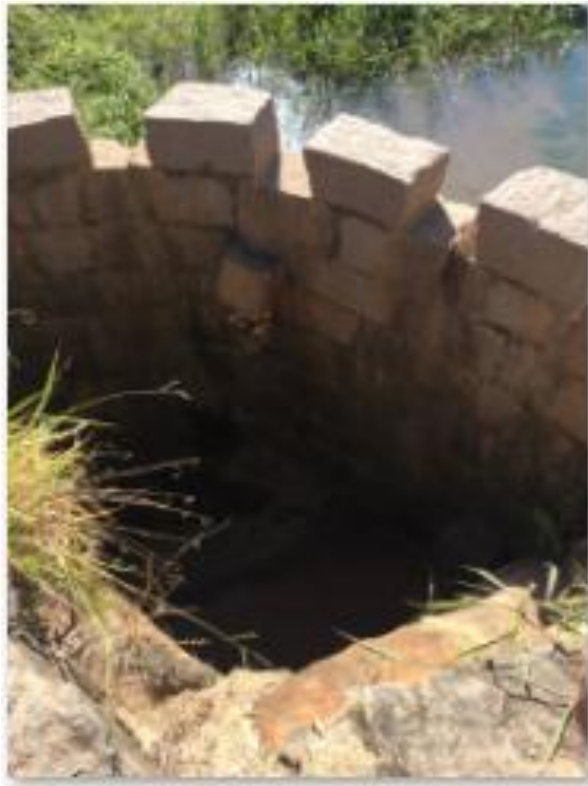
Foto 02: Barramento intensificando o acúmulo de água
