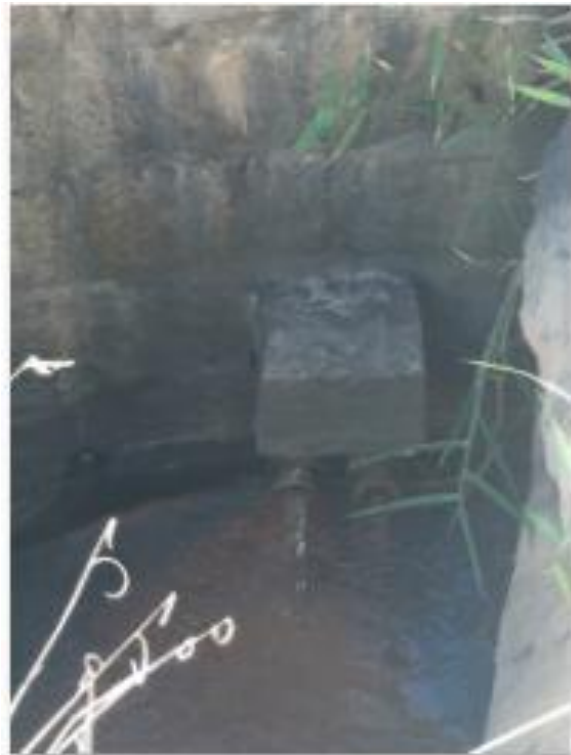
Foto 03: Pequeno escoamento de água
